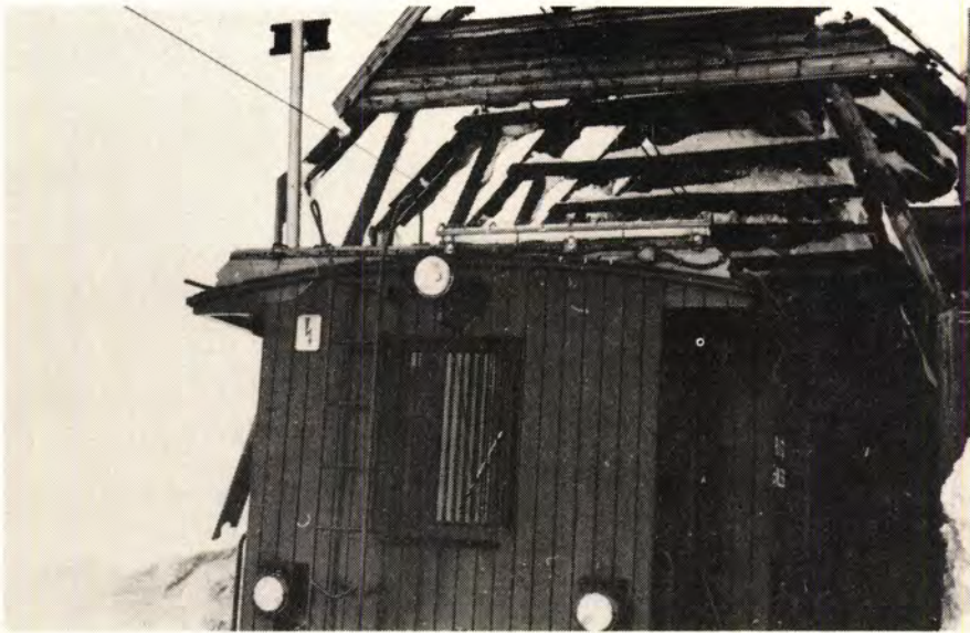
Fig. 5. Munningen av et snøoverbygg som tydelig tilkjenner at den har fått hårdhendt behandling av snøspruten fra den roterende snøplog.
