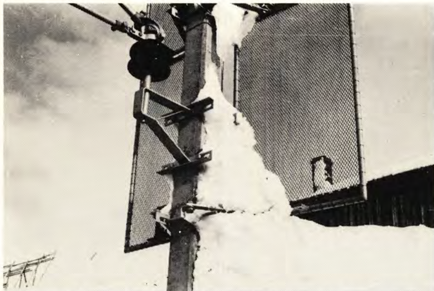
Fig. 4. Betongmaster som er påsatt skjerm for å hindre publikum i å komme i berøring med spenningsførende ledningsdeler. Isolatorene sitter ca. 6,0 m over bakken ved bar mark. (Mars 1968).
