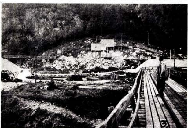
Fig. 4. Kristiansand—Moibanen. 1. Bru over Lyngdalselven ved Snartemo. 2. Hægebostad tunnel vestre innslag. 3. Pukkverket ved 2. avdeling.
