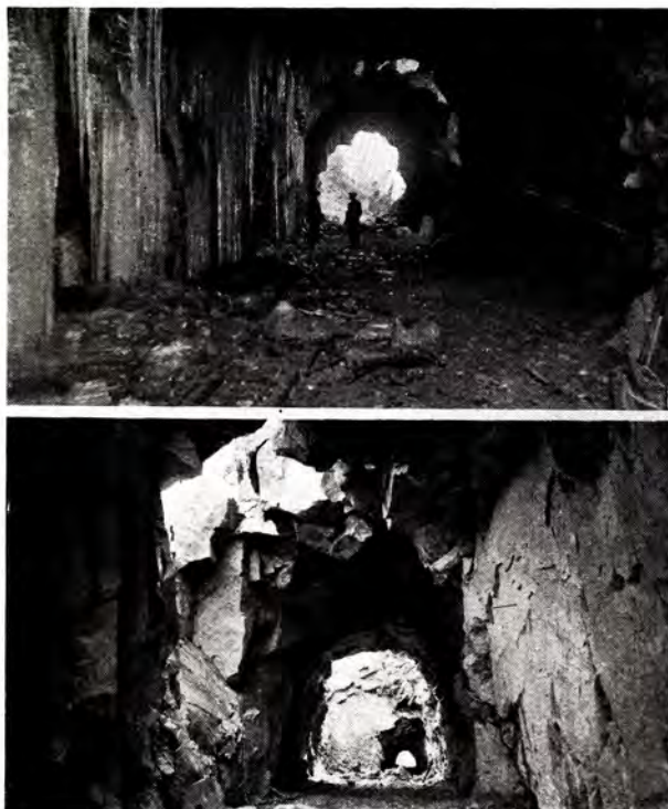
Fig. 8. Øverst: Isdannelse i Illkollhei tunnel. Nederst: Dårlig fjell i Illkollhei tunnel. Åpning i tunneltaket. I bakgrunnen stoll. Km 16,0 fra Kristiansand.
