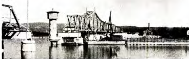
Fig. 16. Svingspennet med vekt ca. 290 tonn under buksering. Fig. 17. Svingspennet på plass. Styre- (komando-) tårnet sees t. v.
