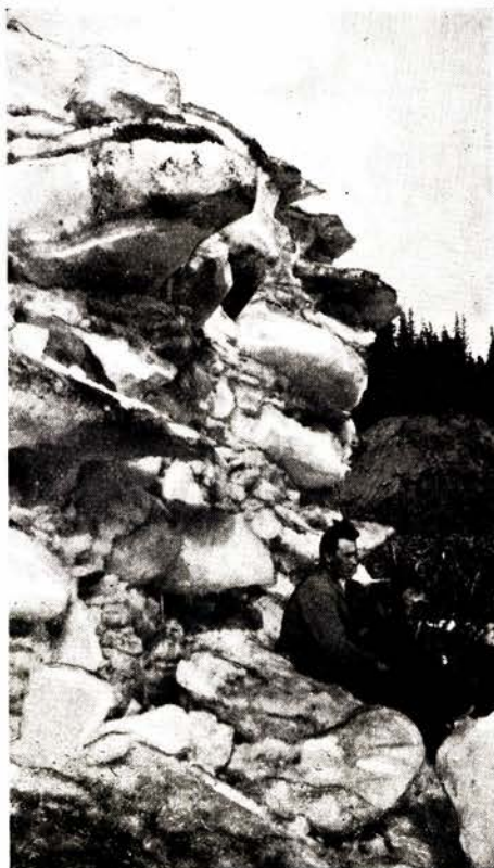
Isskruing i Vefsna foran Leirbekken kulvert. Fyllingen i bakgrunnen.
