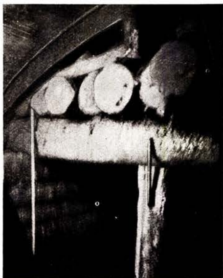
Fig. 3. Et utmurt avsnit og et tilstøtende under avstemping. I øvre venstre hjørne sees endel av den færdige forskalling som hviler paa en lærebue av jern — længere borte væggen av en laftekasse.
