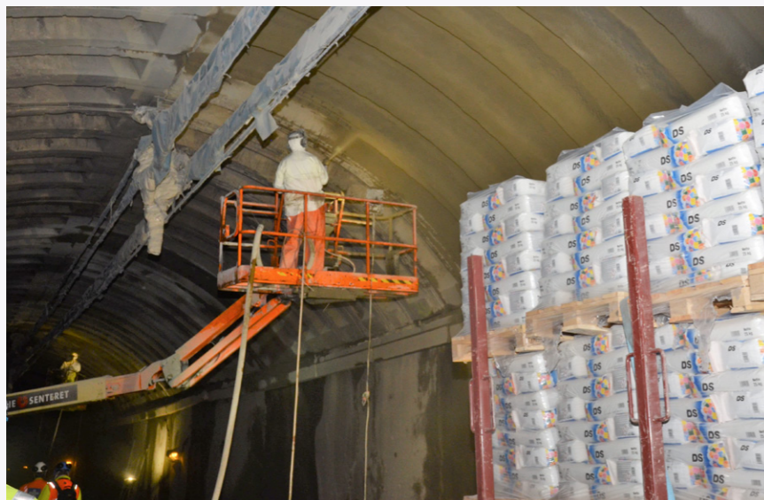
Medan togparken tok sommarferie, blei det arbeid på spreng fleire stadar på jernbanenettet. I Akershus til dømes, blant anna med betongrehabilitering og forsterking av tak og veggjar i Lieråsen tunnel.
