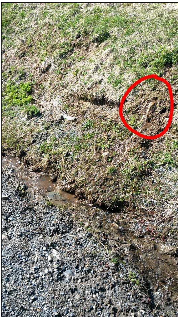
Figur 103: Piping (?), ved et jorde på oversiden av Engan (Økland, 23.04.2015)
