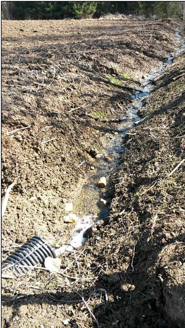
Figur 7: Stikkrenne og grøft langs jordet på oversiden av Engan (Økland, 23.04.2015)
