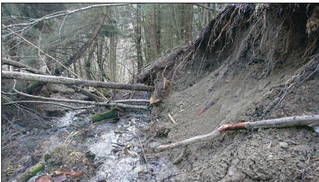
Figur 102: Kraftig erosjon og utglidning, nedstrøms stokkdam 4 (Günther, 10.04.2017)
