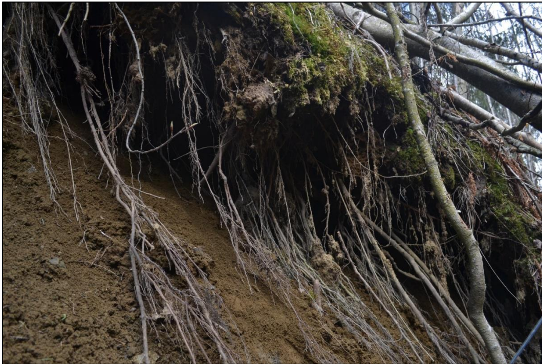
Figur 68: Blottlagte røtter, høyre skråningsside (Økland, 03.05.2016)
