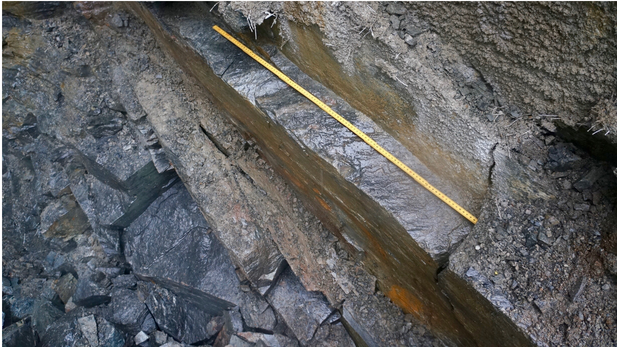
Figur 5.6: Måling av ruheten til sprekkeplan med bruk av a/L metoden.
