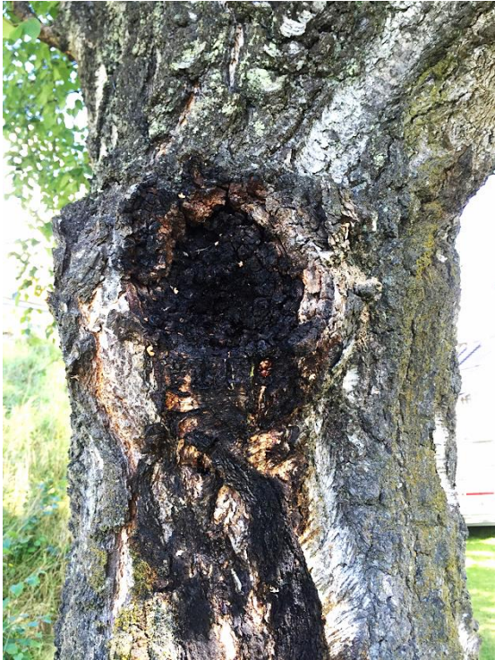
Bilde 4.7: Kreftkjuke ( Inonotus obliquus ) på hengebjørk ( B. pendula ), på Notodden stasjon. Foto: Martin Dalehaug
