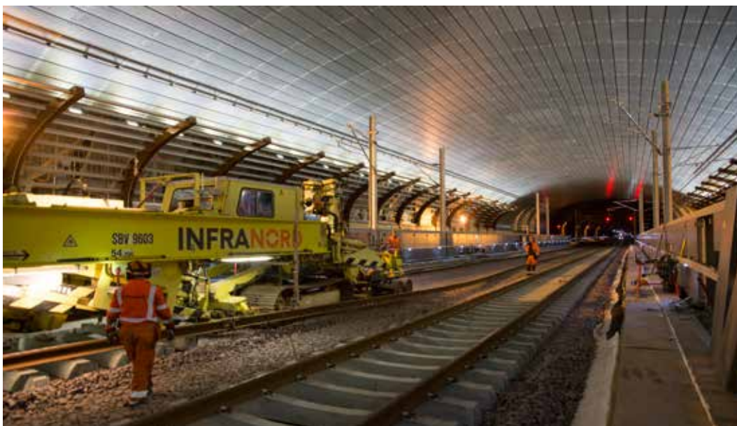
Nye Holmestrand stasjon på Vestfoldbanen blir bygget. Stasjonen ligger inne i Holmestrandfjellet.
