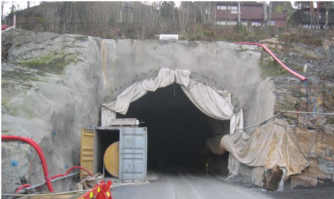
Figur 8: Påhugg med liten overdekning, ventilasjonsvifte skjermet i container. Tverrslag Engervannet til Bærumstunnelen Sandvika Øst
