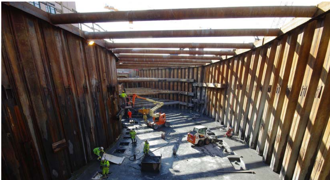
Figur 25: Byggegropp for rampe fra Operatunnelen. Stålspunt med innvendige stålstivere. (Foto: Geovita AS)
