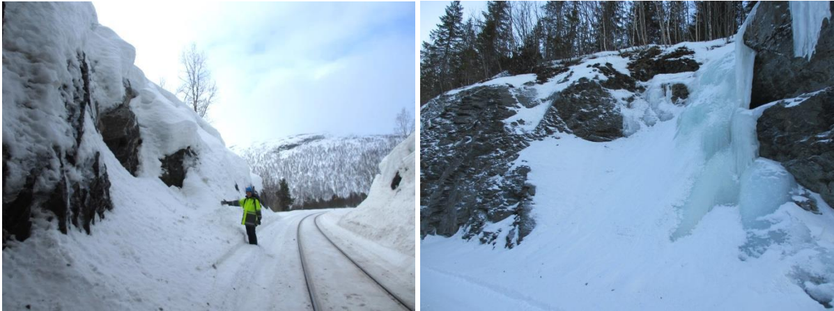
Figur 72a) Isnisje utenfor Hjartåsen tunnel (Nordlandsbanen) reduserer mengden is inn i skinnegangen. Foto: A. Liereng (15.3.16). b) Isnisje i Teveldalen (Meråkerbanen) reduserer problemene med is inn i profilet for togene. Foto: A. Liereng (19.2.16).
