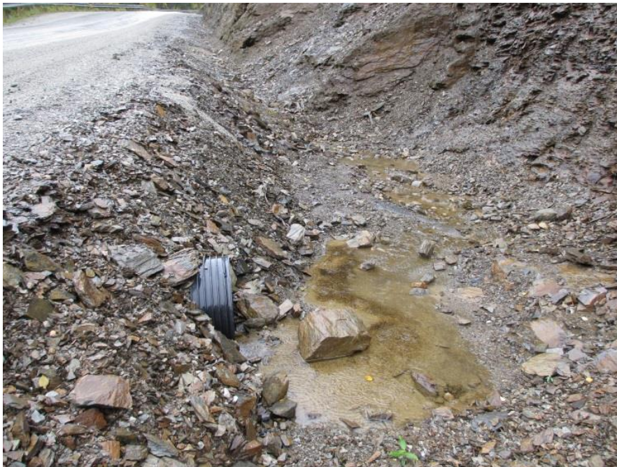
Figur V- 45) Stikkrenne under vegen nedenfor skredbanen. Grøfta er bred og dyp, og har god lagringskapasitet for is. Foto: A. Liereng (20.9.15)
