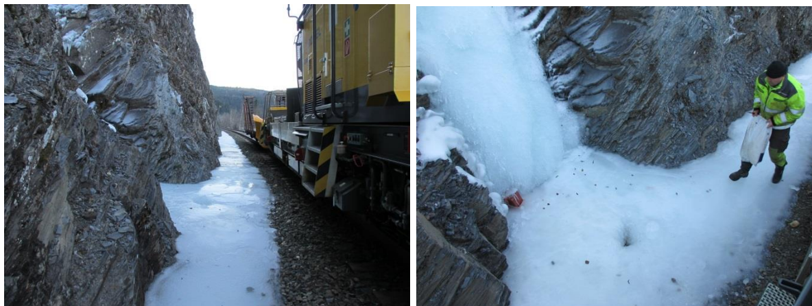
Figur V- 7a) Iskjøving i bekkeløpet har tettet stikkrenna. Dette har ført til omfattende iskjøving i grøfta langs skjæringen. b) Nedre del av nedføringsrenna. Det lille hullet i isen er laget med salt og viser plasseringen av stikkrenna. Det er lagt ut saltstein for å smelte en åpen kanal for vannet ned til stikkrenna. Foto: A. Liereng (15.1.16)
