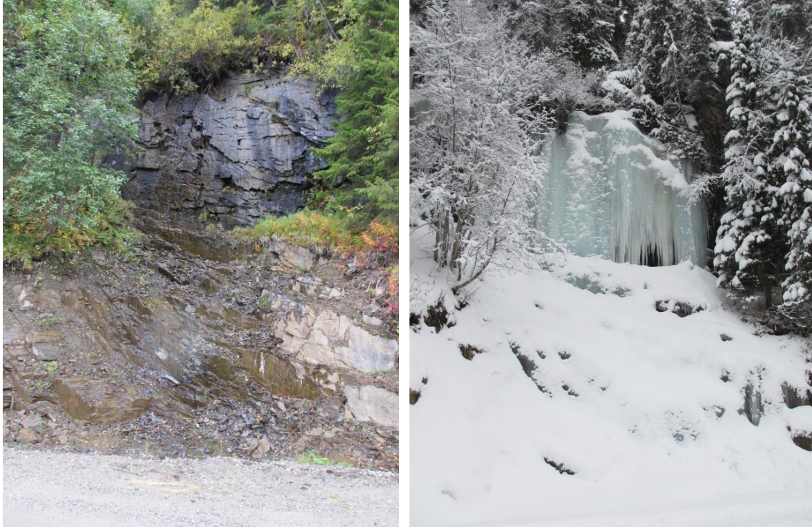
Figur V- 46a) Berget er dryppende vått. Det er lagt stikkrenne under vegen for å ta unna vannet. Foto: A. Liereng (20.9.15). b) Iskjøving i bergveggen. Foto: A. Liereng (26.3.16).
