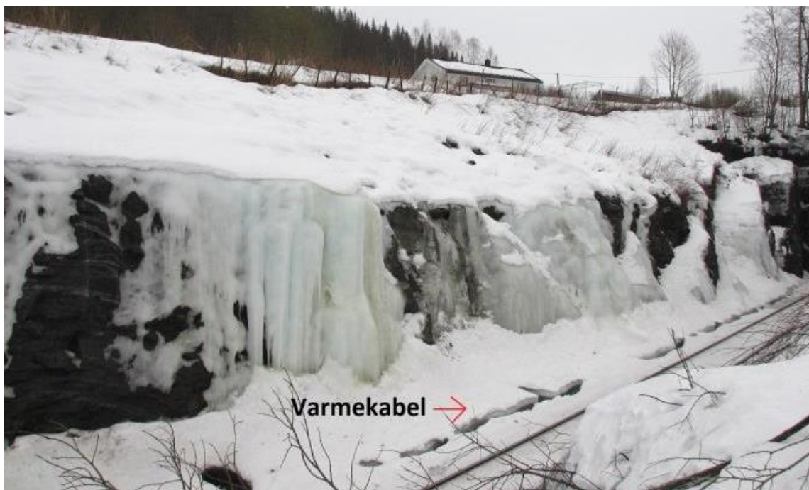
Figur V- 81) Iskjøving i skjæringen utenfor tunnelen. Isen starter i toppen av skjæringen der løsmassene er fjernet. Det er lagt varmekabel i grøfta. Foto: A. Liereng (15.3.16)
