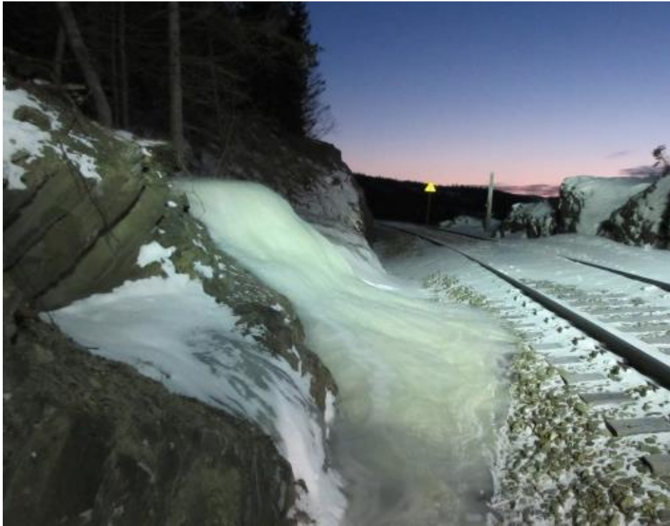
Figur 29. Iskjøving fra grunnvann langs Meråkerbanen. Det pleier ikke å være is her, men sterk kulde i kombinasjon med barfrost har ført vannet til nye steder. Foto: A. Liereng (15.1.16).
