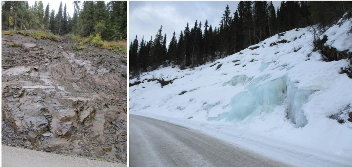
Figur 33a) Dalsiden ovenfor Tann-Annolsetervegen i Breidalen er ryddet for jord og løsmasser etter et jordskred. b) Dette øker varmetapet for grunnvannet i området og forårsaker iskjøving. Foto: A. Liereng (20.9.15 og 26.3.16).
