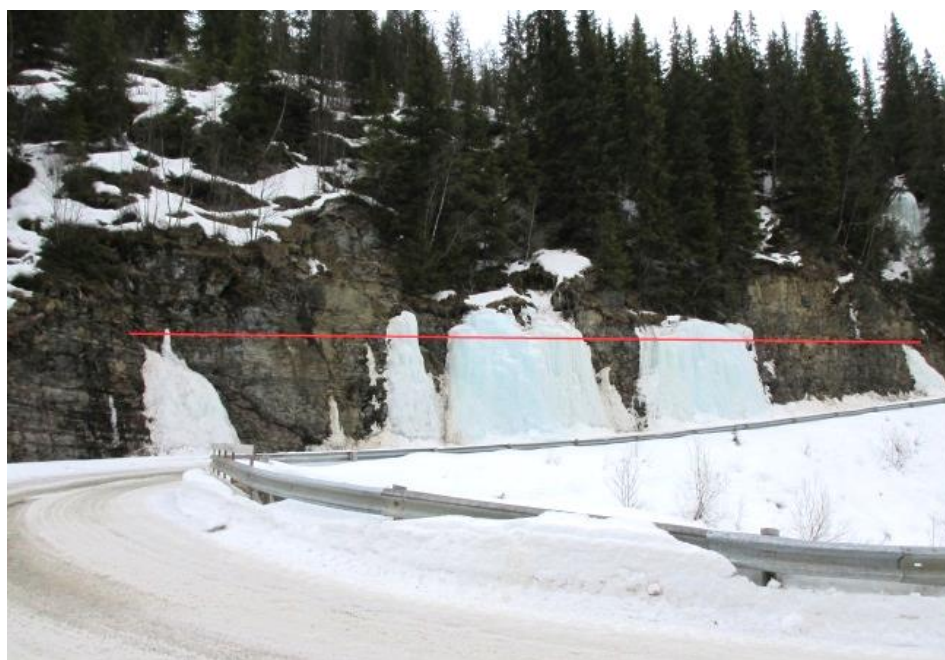
Figur V- 52a) Skjæringen øst for elva er våt i flere partier. Alt vannet kommer nedenfor et bestemt nivå, se den røde streken. Foto: A. Liereng (20.9.15). b) Iskjøving oppstår i de våte partiene av skjæringen. De største issvullene oppstår der det renner vann fra løsmassene. Foto: A. Liereng (26.3.16).
