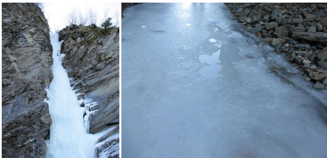
Figur V- 8a) Øvre del av nedføringsrenna er smalere enn den nedre delen. Det er mindre is i toppen av skjæringen enn i bunnen ved stikkrenna. b) Vannet fra bekken sprer seg ut i grøfta siden stikkrenna er utilgjengelig. Det er mye vann over isen i grøfta, og vannet er dekket av et tynt islag. Foto: A. Liereng (15.1.16).
