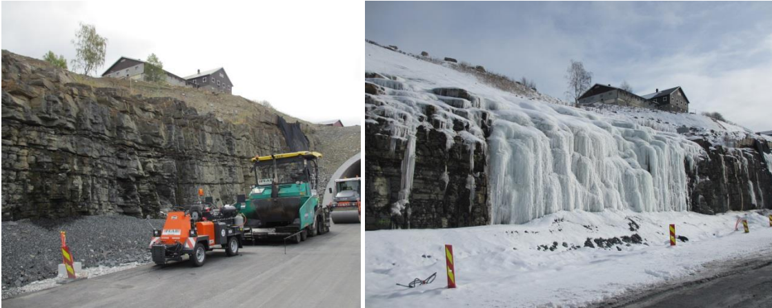
Figur V- 73a) Skjæringen rett utenfor tunnelportalen. Berget er litt vått i enkelte partier, av vann som kommer fra sprekker, Foto: A. Liereng (19.5.16) b) Iskjøving i skjæringen rett utenfor tunnelportalen. Foto: A. Liereng (11.3.16).
