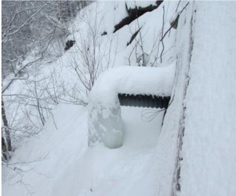
Figur 14) Iskjøving i utløpet av en stikkrenne. Fv 651, Telemark. Foto: A. Liereng (3.3.16).
