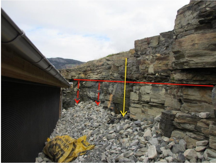
Figur V- 75) Det renner vann i to konsentrerte vannveger langs berget. En av dem er vist på bildet med gul pil. I tillegg renner det vann fra et horisontalt, oppsprukket lag midt i skjæringen, markert med rød linje. Foto: A. Liereng (19.5.16).
