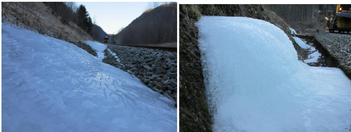
Figur 54a) Isen kan bygge seg opp til issvuller med horisontale lag. b) Når helningen på issvullen blir nær vertikal, kan isen vokse i bølgete overflate. Meråkerbanen. Foto: A. Liereng.
