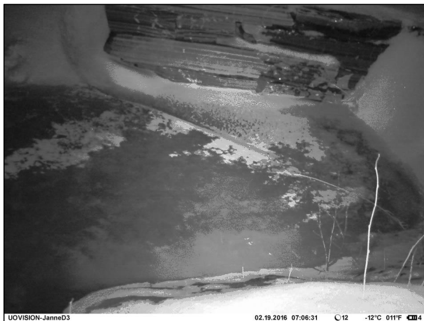
Figur 85. 19.02.16 er stikkrenne D3 helt fylt opp av is. Isen går et stykke over innløpet, og fyller gradvis opp hele området foran.
