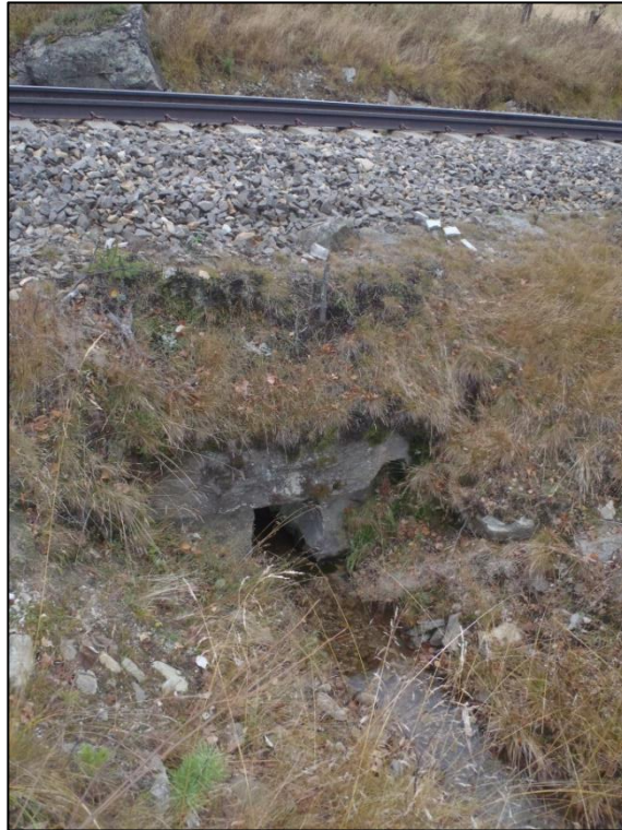
Figur 38. Km 318,880, D2. Utløp til stikkrenne før oppsett av kuldeskjørt. Vanlig med kjøving fra utløp og videre oppstrøms
