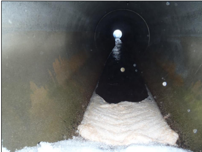
Figur 90. Ingen is observert inne i stikkrenne Ø3, 4. april 2016
