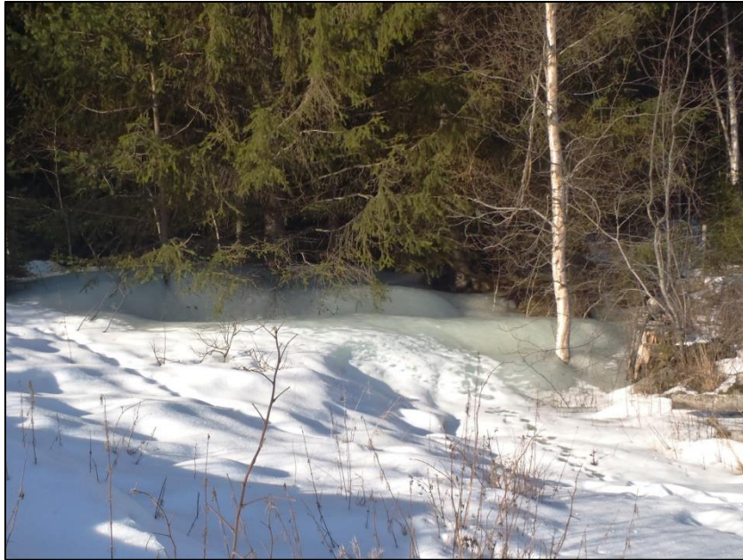
Figur 86. På feltbefaring 17.03.16 var det tydelig at kjøvingen starter et godt stykke ovenfor stikkrenne D3. Svellis kan ses under grantreet, og legger seg også rundt bjørka til høyre.
