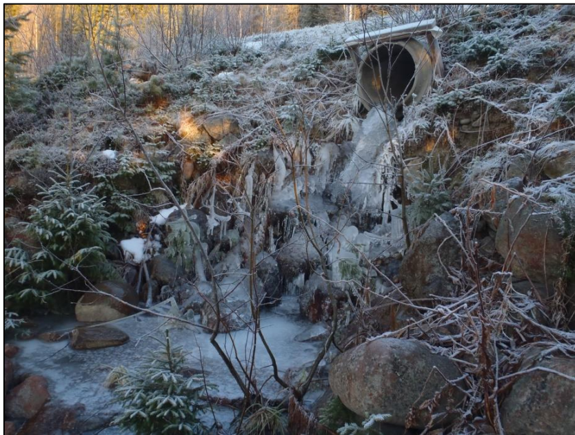
Figur 29. Utløp Ø2. Fiberduken er fjernet i 2015, rammeverket står fortsatt.
