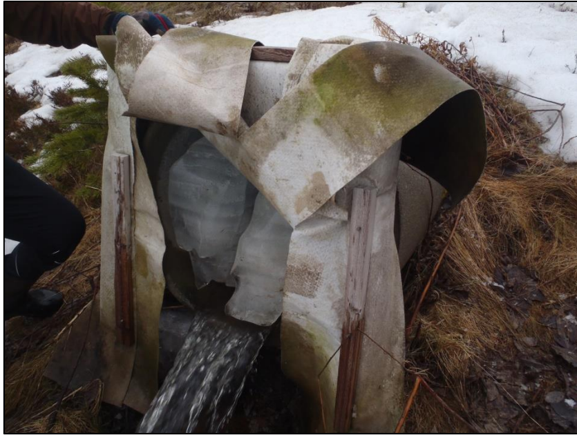
Figur 87. Observert isdannelse i utløp på stikkrenne Ø1.
