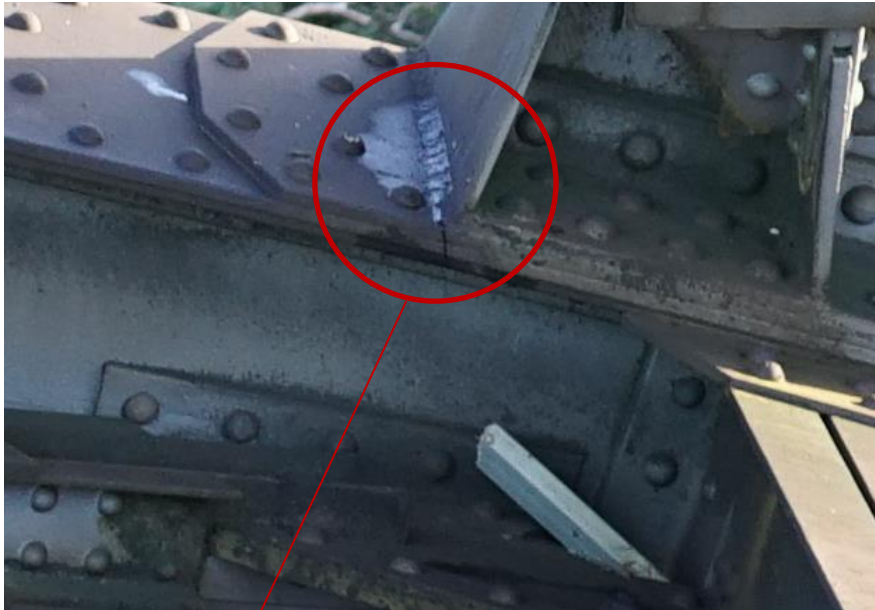
Sprekk ved sveis?
