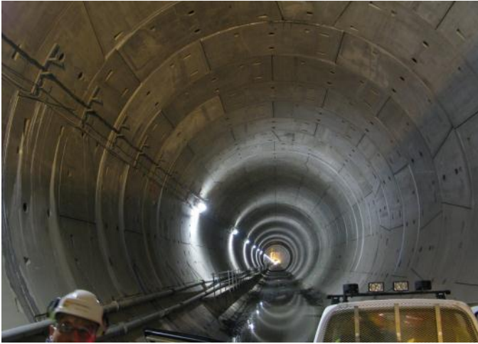
Figur 68 Tunnel boret av tunnelboremaskin kledd med betongelementer. Hallandsås tunnel i Sverige. Foto: Jernbaneverket/Amberg
