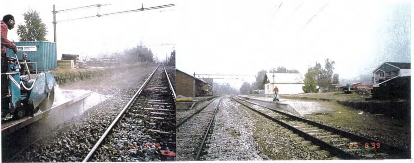
Betongsaging opp til 8 cm i utkraging pga. feil ved utstikning
