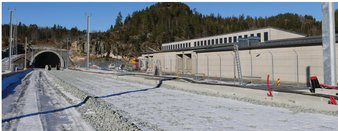
Øverst f.v. Herregårdsbekken ved Lillegårdkrysset i Porsgrunn, øverst t.h. fra Pauler mot Hallevannet Dronefoto: Terje Hammersland, Bane NOR. Nederste bilde er fra Solum der det bygges ny omformerstasjon. Tunnelåpningen til Nøklegårdtunnelen i bakgrunnen til venstre. Foto: Trine Bratlie Evensen Bane NOR.
