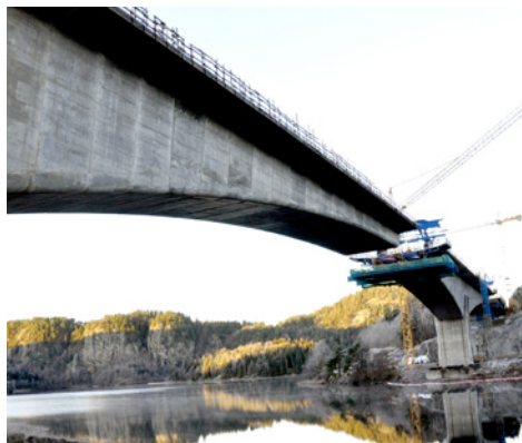
Hallevannetbrua under bygging. Byggemetoden kalles frittrembyggd og det støpes på likt fra hver side av brufundamentene helt til de to vognene møtes på midten.
