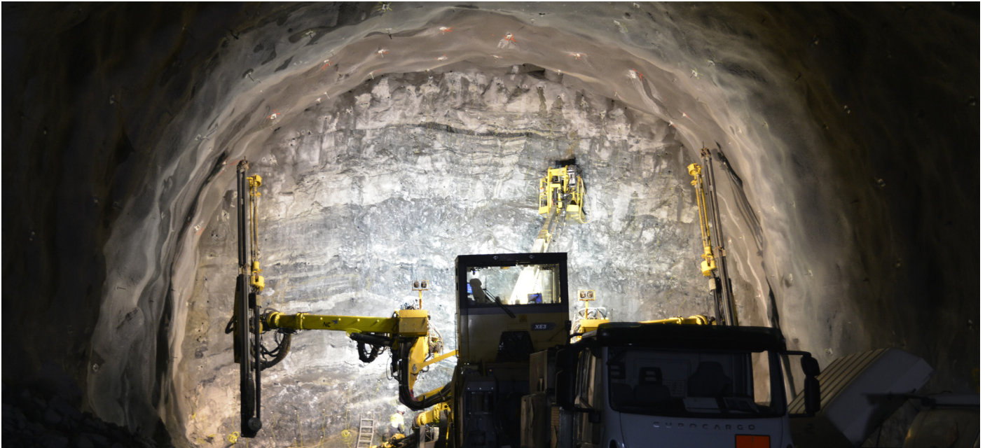
Foto: Trine Bratlie Evensen. Vi er godt i gang med arbeidene med det som blir Eidanger tunnel.
