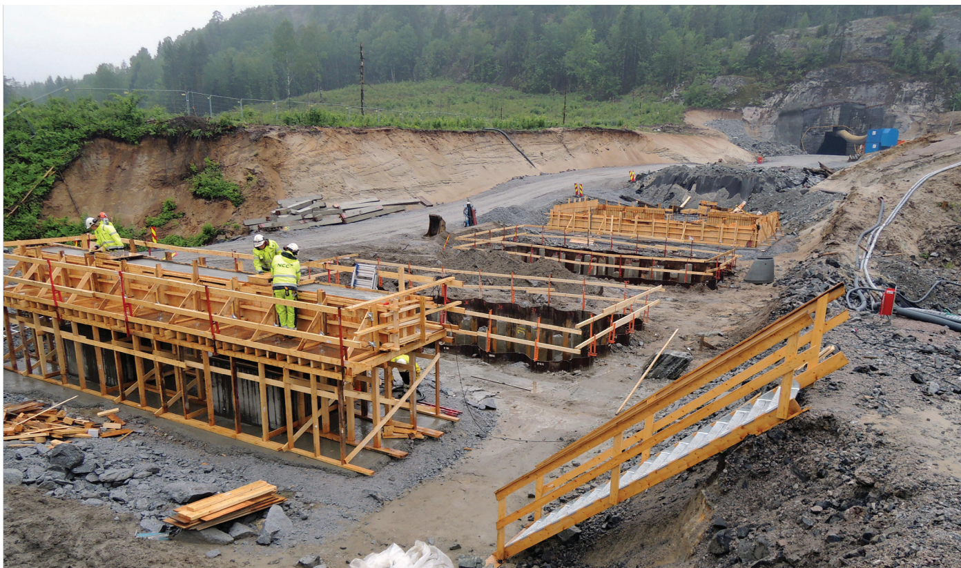
Arbeidene med fundamentene til Herregårdsbekken bru er i gang. Eidangertunnelen kan skimtes i bakgrunnen. Foto: Marianne Hvaal Larsen, Jernbaneverket
