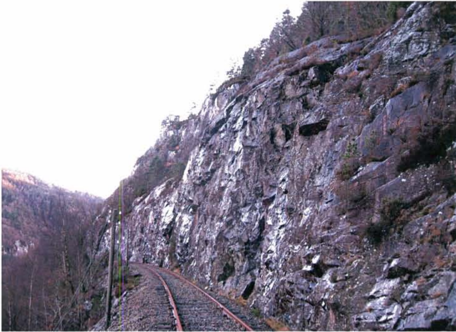
Figur 2 Høy uoversiktlig skjæring og bratt sideterreng ved Lavoll, km 10,10
