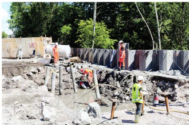
Vi er i gang med å bore ned tilsammen 34 stålkernepeler til fundament for gang- og sykkelbroen over stasjonen.
