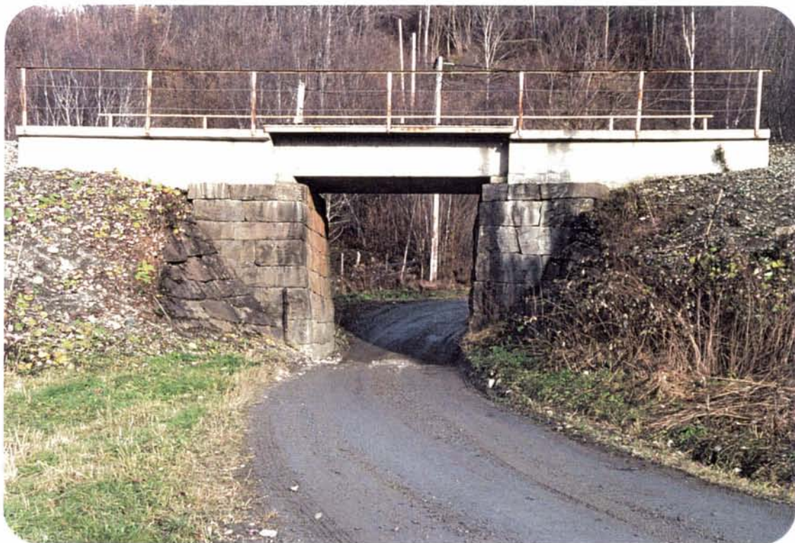
Foto 25: Modernisert bru over lokalveg sør for Kvål. Stålbjerkene er erstattet med betongtrau. Dette påvirker bruas arkitektoniske uttrykk. Det blir en kollisjon mellom dagens og gårdsdagens formspråk og teknikk. Jfr. foto 19 side 30.
