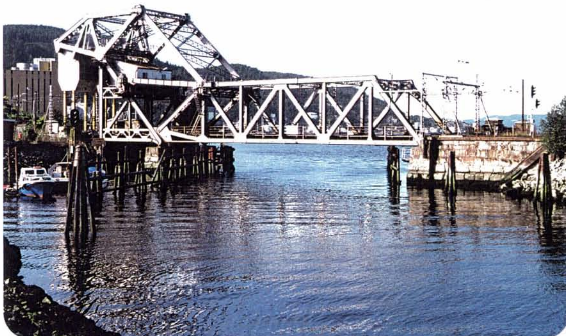
Foto 5: Skansen klaffebru (1921) er et sjeldent og verdifullt teknisk kulturminne, også i internasjonal sammenheng.
