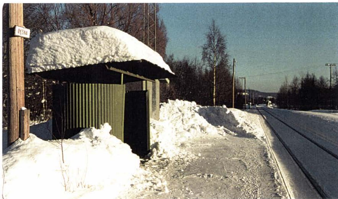
Foto 21: Ved Øksna er stasjonsbygningen revet, og de reisendes bekvemmeligheter har i ettertid bestått av et heller trist léskur av "plavinyl-typen" (1960-årene?). Denne typen fins også ved Ebru øst for Løten. Skuret bør kanskje bevares som eksempel på NSB's rasjonelle arkitektur fra denne epoken?
