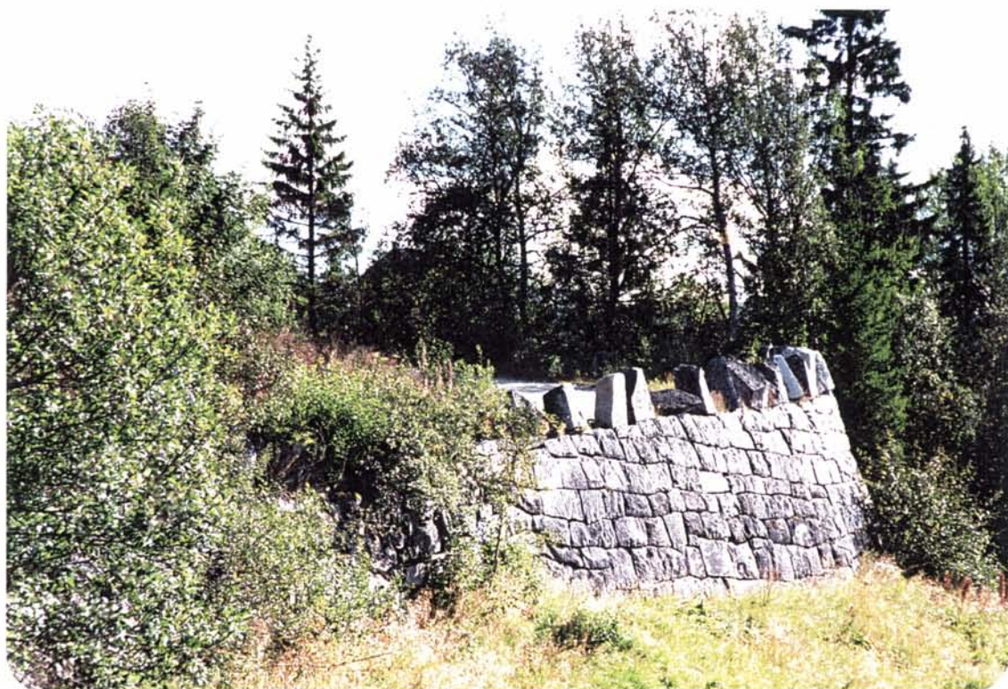
Foto 94: Vegen opp til Ålen holde plass er bratt, og har bl.a. medført bygging av denne fine forstøtningsmuren oppe ved holdeplassen.
