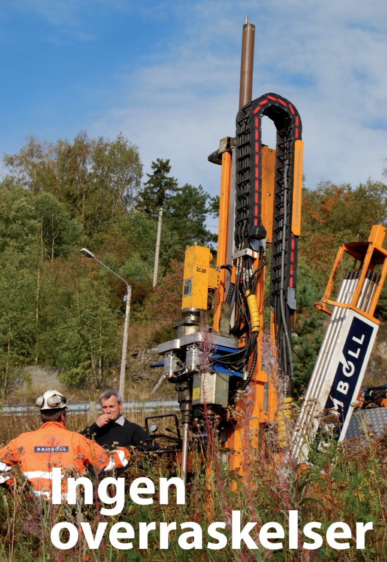
◀ GRUNNBORING: Prosjektsjef Brede Nermoen (t.h.) på befaring under grunnboringene i Hommelvik tidligere i høst.
