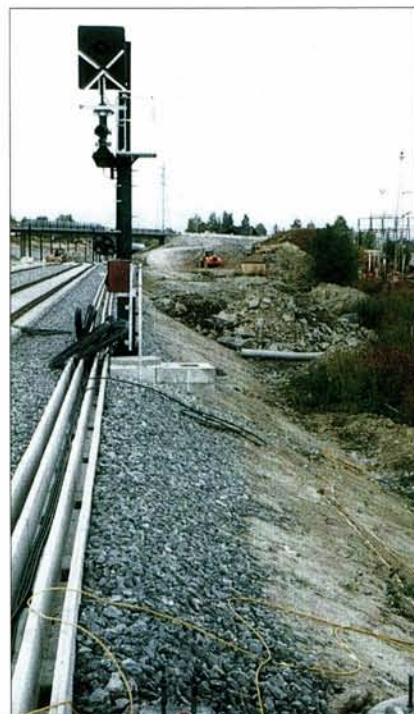
Signalanleggene til Gardermobanen er de første i Norge som sikrer togfremføring i hastigheter over 200 km/t. Foto: NSB-GMB.
