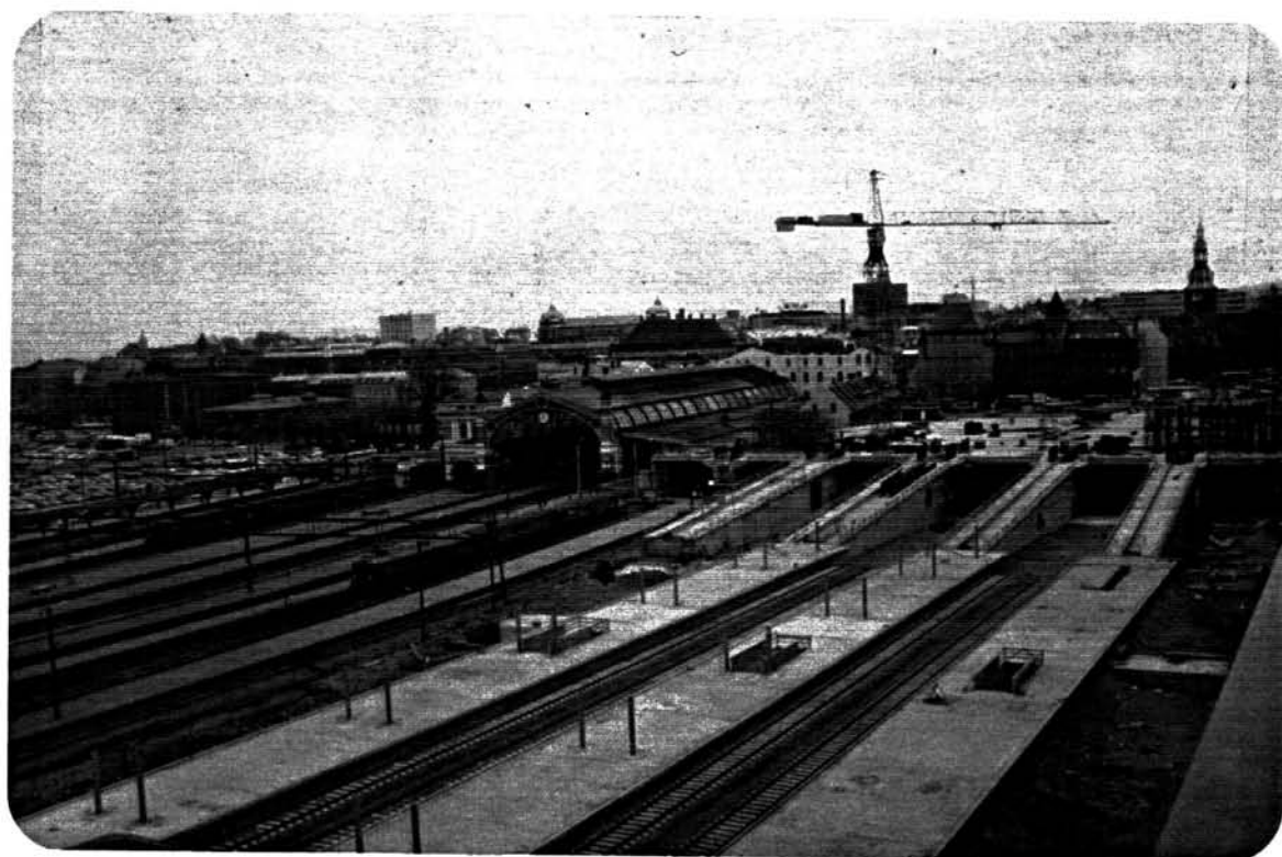
Situasjonen i 1978. De nordligste spor og plattformer under bygging. Innkjøringen til Oslo-tunnelen klar.
