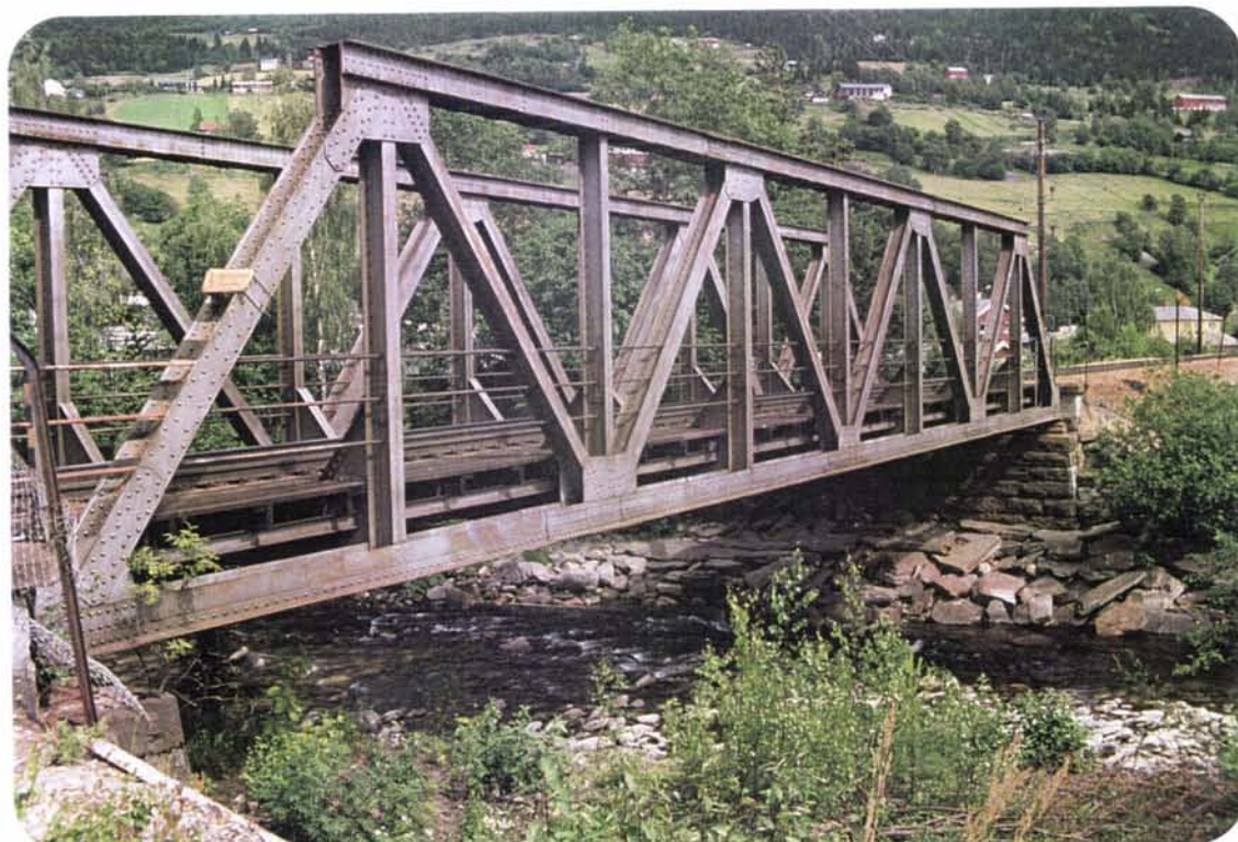
Foto 76: Fagverksbrua over Våla er tidstypisk fra banens anleggstid. Brua over Frya lenger nord er av samme konstruksjon.
