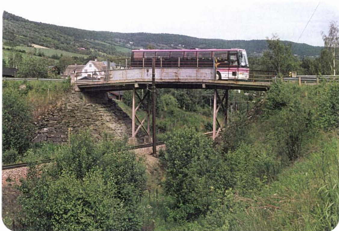
Foto 84: En av banens mange overgangsbruer som hviler på spinkle fagverkspillarar og kar av naturstein. Disse bruene er karakteristisk for banen og gir et lett og luftig inntrykk.
