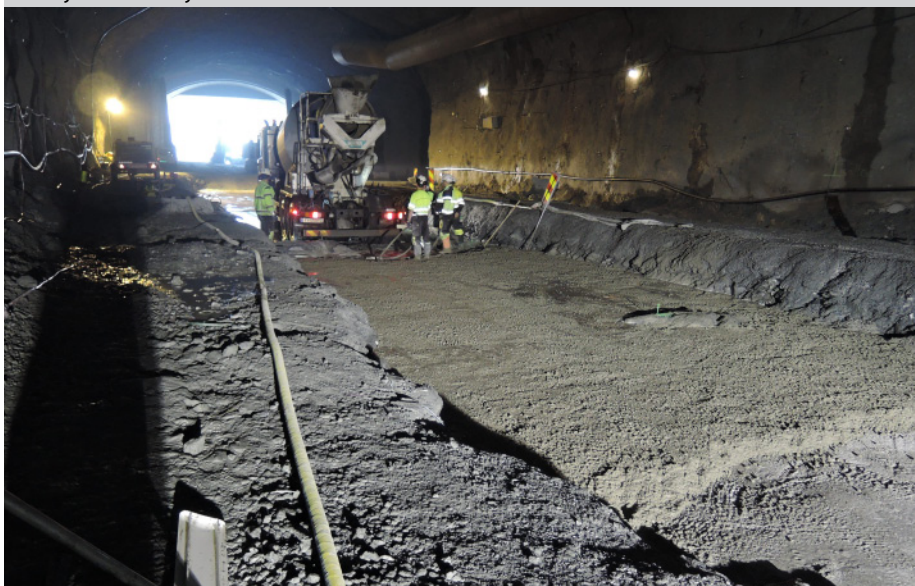
I bunnen av den nye tunnelen støpes et betongdekke som tunnelboremaskinen skal skli på når den fraktes inn til startpunkt for boringen.
