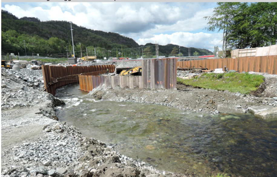
Storelva ledes gjennom en midlertidig kanal til side for åpningen på vanntunnelen under Arna stasjon.
