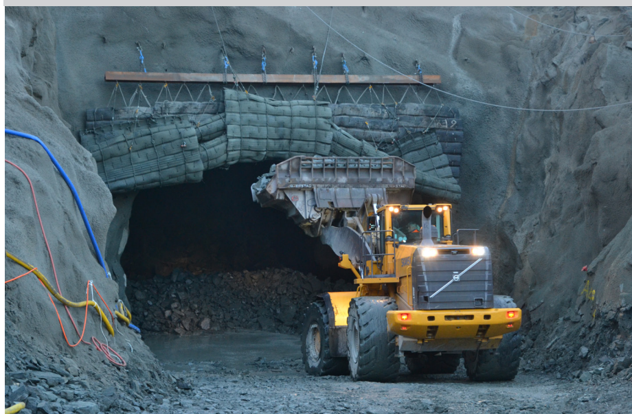
Her er en hjullaster i gang med å fjerne sprengsteinen fra tunnelen før neste salve.
