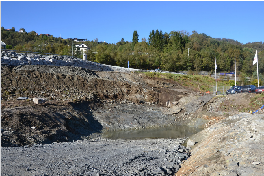
Arna: I dette området skal anleggstunnelen gå inn under veien Reinane. Til høyre i bildet skimtes veibroen over eksisterende tunnel.
