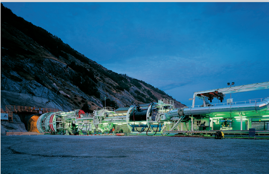
En slik maskin skal bore 7 kilometer av nye Ulriken tunnel. Den vil bli montert bit for bit ute på anleggsområdet og skyves inn i fjellet gjennom den sprengte delen av tunnelen.
