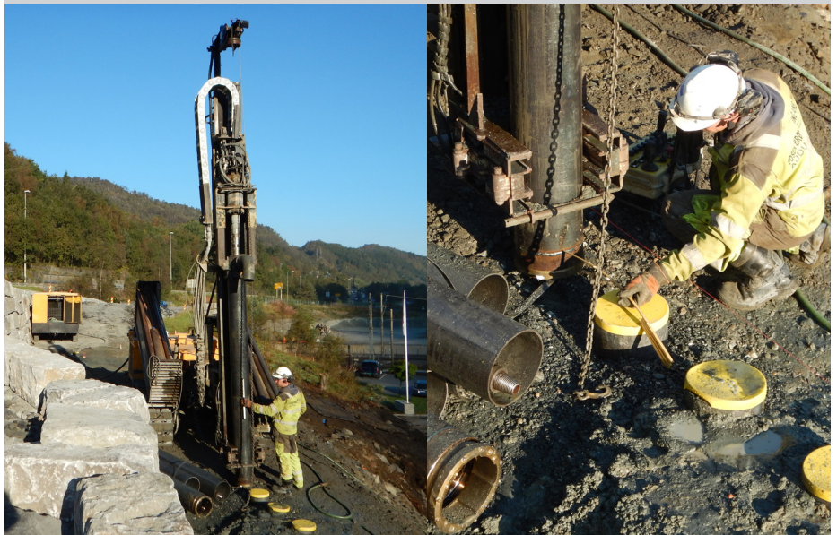
Arna: Ved hjelp av en borerigg settes rør ned i fjellet på rekke slik de danner en vegg som holder terrenget på plass.
