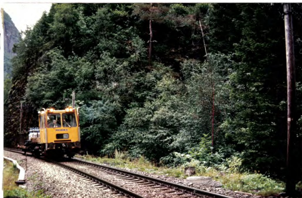
Foto 3. 394.600 Slito (Suto) Senkningen til høyre for linja fylles med skredmasser som kan medføre vannsig gjennom fyllinga.
