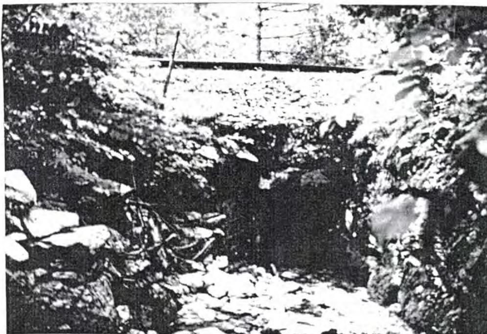
Foto 10. Bekkeløp/kanal med materialavsetninger ned mot stikkrenna. Stikkrenna ikke dimensjonert for å ta unna skredmasser. (400.940 Kvernhusgrova?)
