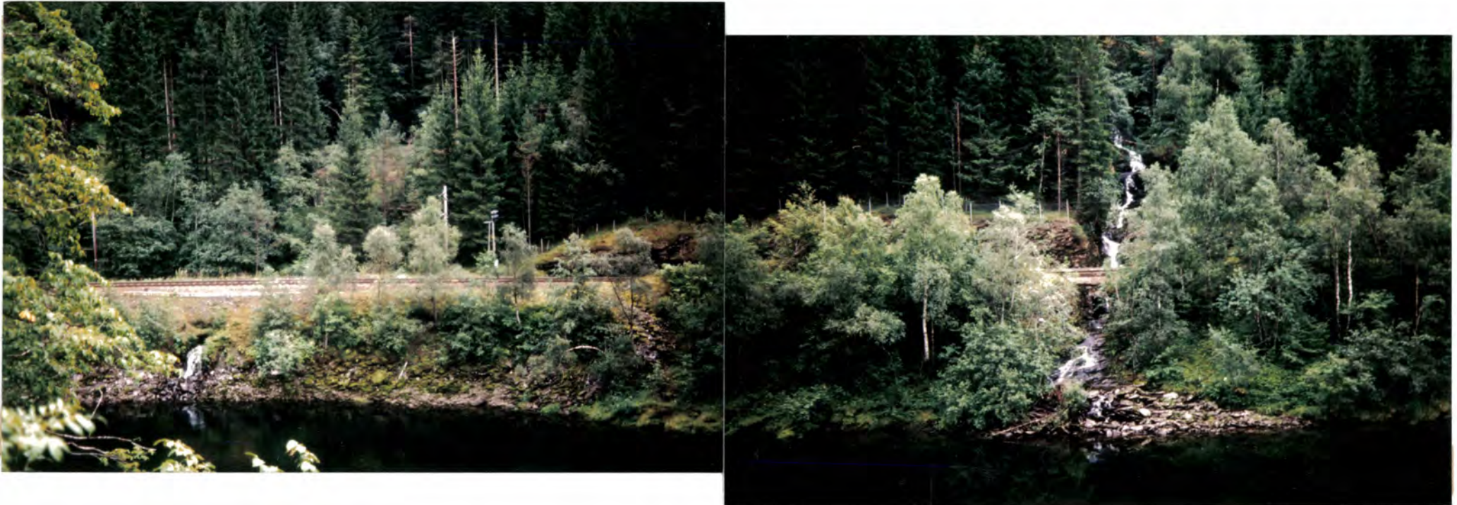
Foto 1. 394.600 Slito (Suto) østre nedløp og 394.650 hovednedløp Linja ligger i 2-sidig fjellskjæring på begge sider av det trange hovedløpet. Når østre kulvert går tett kan det oppstå vannsig gjennom fyllinga. Et aktuelt tiltak kan være å etablere 2 overløpskanaler i fyllinga.
