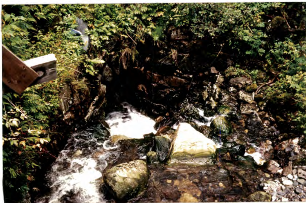
Foto 23B. 444.260 Djupedalselva. Akkumulasjon av flomtransportert materiale har medført at innløpet til stikkrenna på 1.2 x 2.0 m 2 ligger mye lavere enn elvebunnen i forgrunnen. For å redusere ulempene når stikkrenna går tett kan det etableres en ny overløpskanal like under banelegemet, dimensjonert for å ta unna forventet flomvannsføring.
