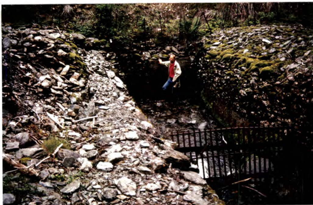
Foto 5. 395.600 Vikagrovi Bekk med stor materialføring og med underdimensjonert kulvert og fangrist. Utgravd materiale er lagt opp på sidene av kanalen og vaskes nedi igjen i flom. Erstatning av dagens stikkrenne med bru vil være beste sikringsmåte.
