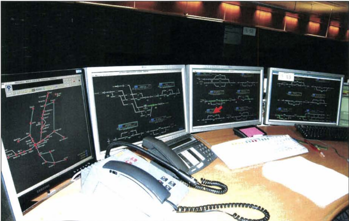
Figur 11: Togleders betjeningsplass for Gjøvikbanen. Rød pil viser Stryken stasjon. Storskjerm sees i bakgrunnen.
