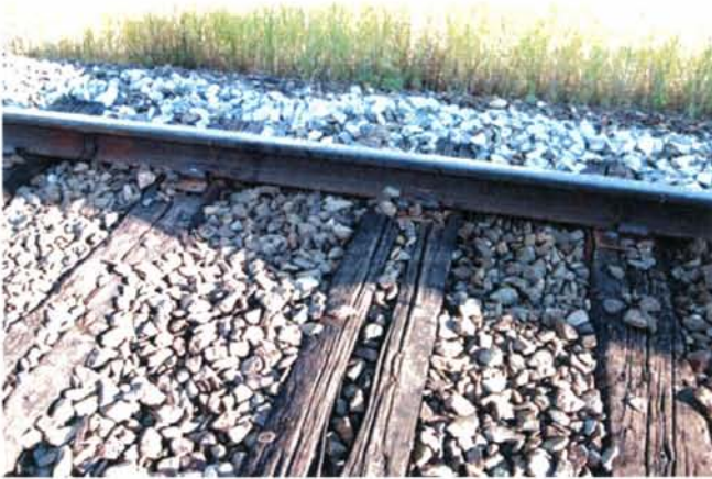
Figur 4: Tresvillene fra 1961 var generelt i dårlig forfatning.
