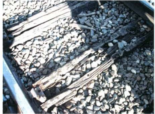
Figur 5: Flere tresviller i dårlig forfatning.
