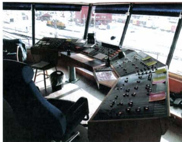
Figur 4 Arbeidsplassen ved slippstillverket. Manøverpanelet for bremsene til venstre
