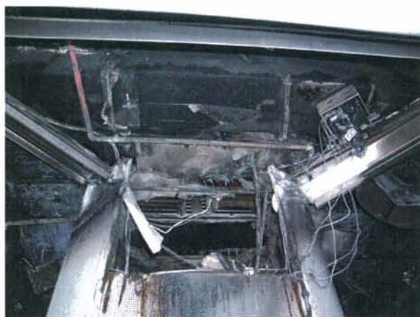
Figur 1 Brannskader i toppen av bagasjesøylen og taket i vestibyle 2 i BM 71003.
