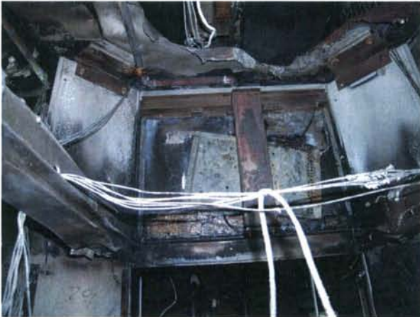
Figur 5: Bakveggen av en monitor etter brannen. I toppen av bilde sees at skilleveggen mot varmeelementene er smeltet.
