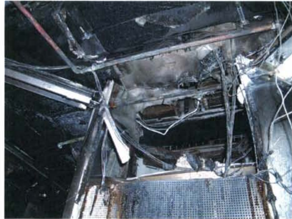
Figur 6: Bagasjesøylen sett fra siden mot inngangsdøren. Polykarbonatplaten som dekket øvre del av sideveggen har smeltet og brent opp.
