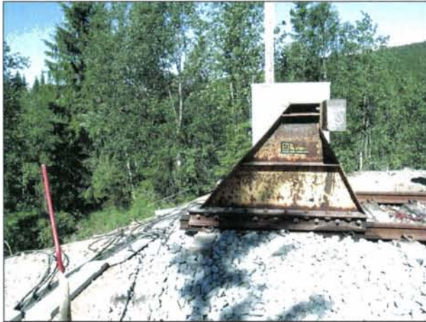
Figur 9: Endebuttstokk med ødelagt kabelkanal.
