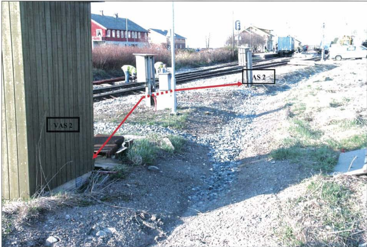
Figur 10: Viser trasèen hvor den defekte kabelen var nedgravd mellom veibomkiosk VAS 2 og apparatskap AS II.
