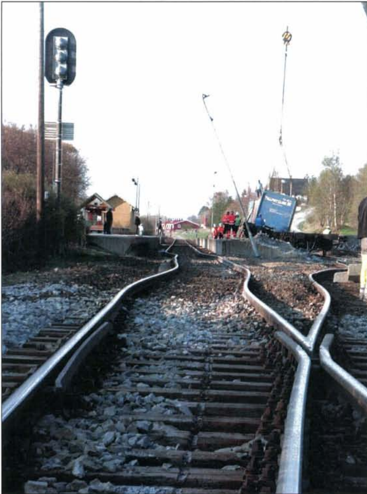
Figur 7: Viser at det oppstod omfattende skader og forskyvning av sporet. Vognen som stoppet i spor 1 var fjernet da bildet ble tatt under oppryddingsarbeidet.
