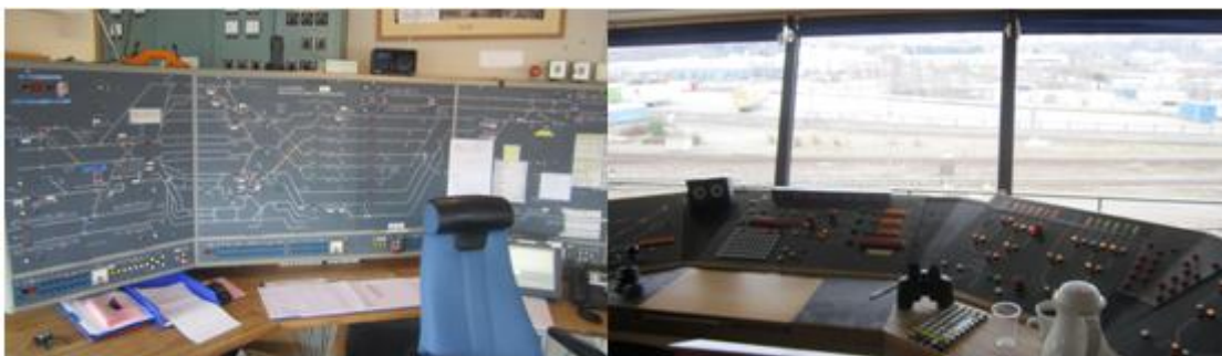
Figur 1 TXP kontrollrom. Bildet viser stillerapparatet brukt til å styre trafikken på en godsterminal.
