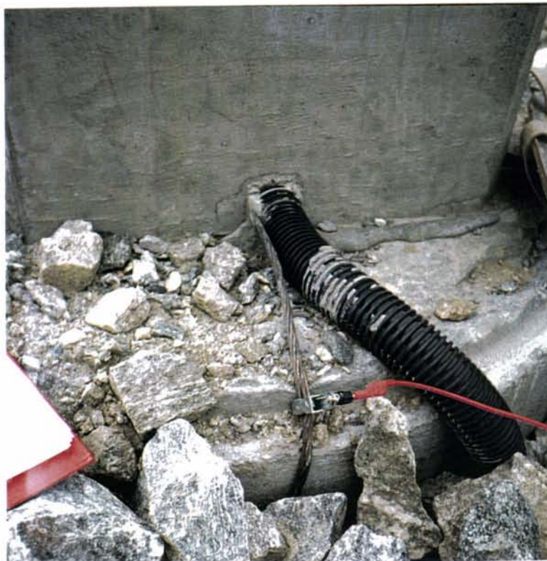
Bilde 3: Tilkobling til kobbertråd fra mastefundament
