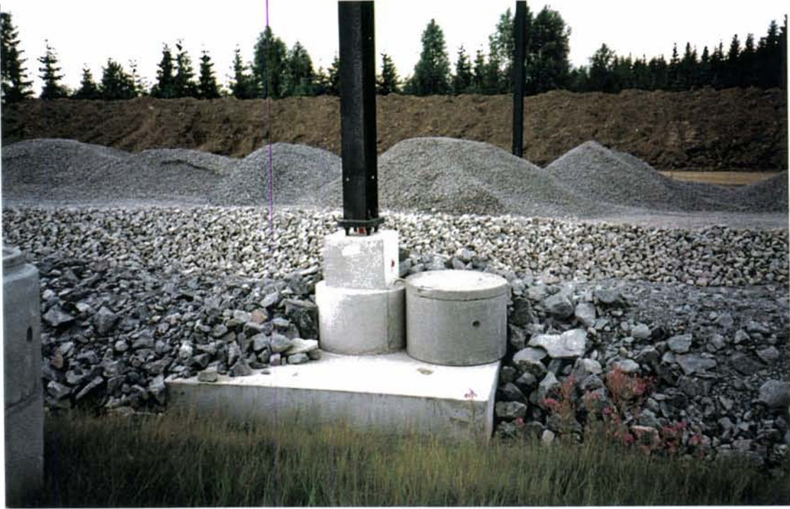
Bilde 1: Sålefundament med mast og kum for tverrforbindelse
