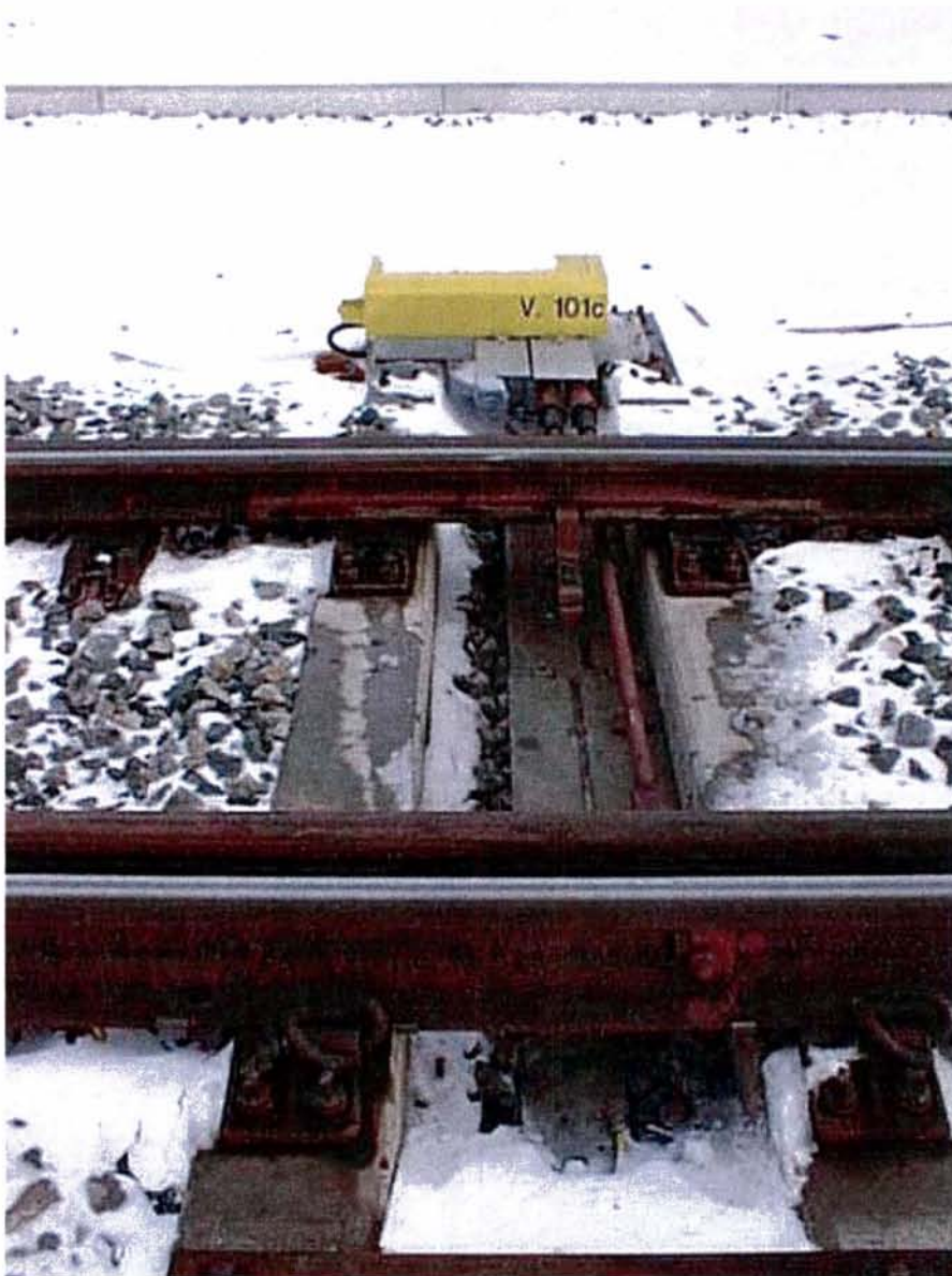
Bilde 13 Rådegravsvarme V1 Rygge stasjon. Installert effekt 2x450W elementer montert på galvanisert stålplate
