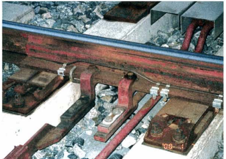
Bilde 4 Klips som ble montert da originale klips ikke passet
