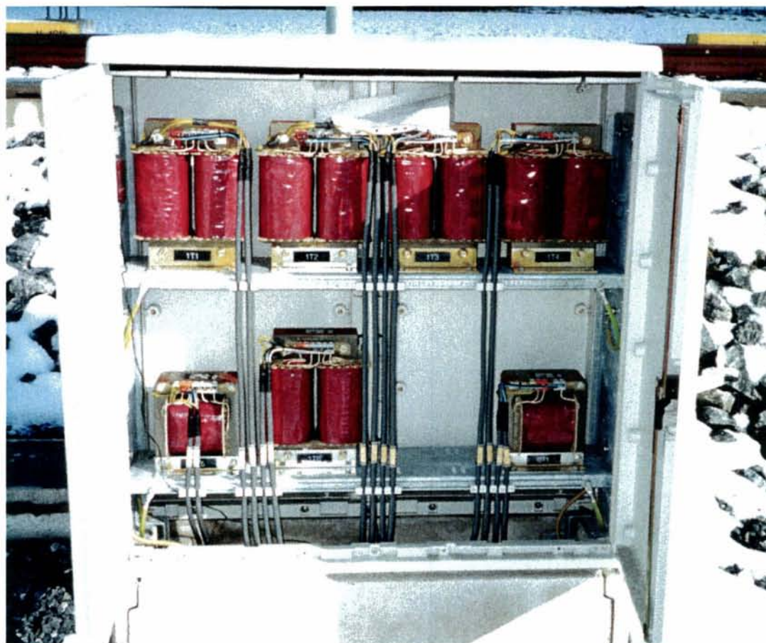
Bilde 11 Transformatorskap V 1 Rygge stasjon
