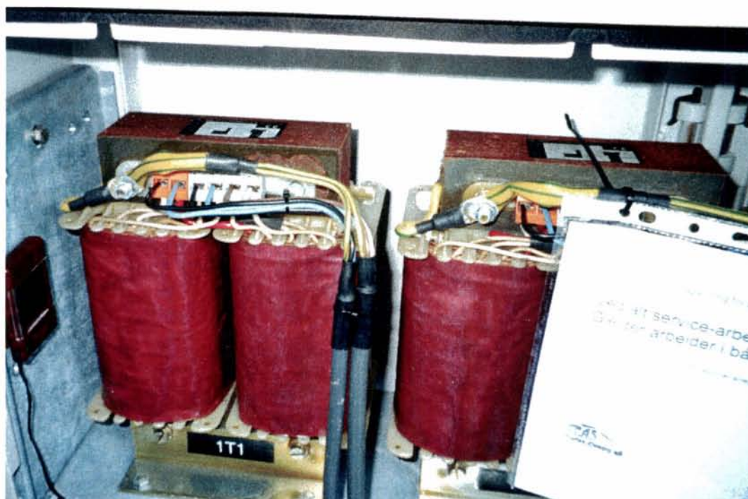
Bilde 12 Nærbilde av skilletransformator primær 230V , sekundær 2x230V , 2x1,5KVA Trafoskap V 1 Rygge stasjon,
