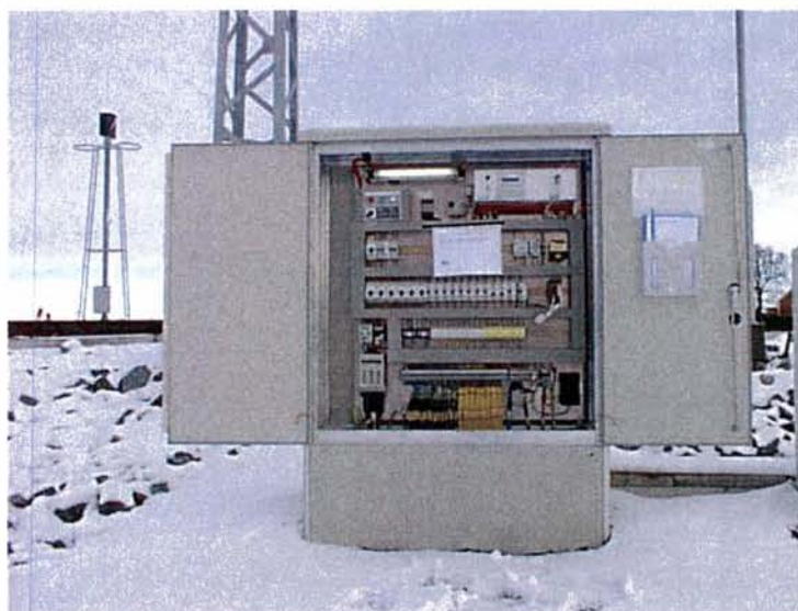
Bilde 8 Styreskap V 1 Rygge stasjon
