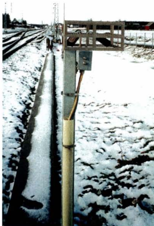
Bilde 6 Nedbørsdetektor m/ beskyttelsesgitter V 2 Haug stasjon
