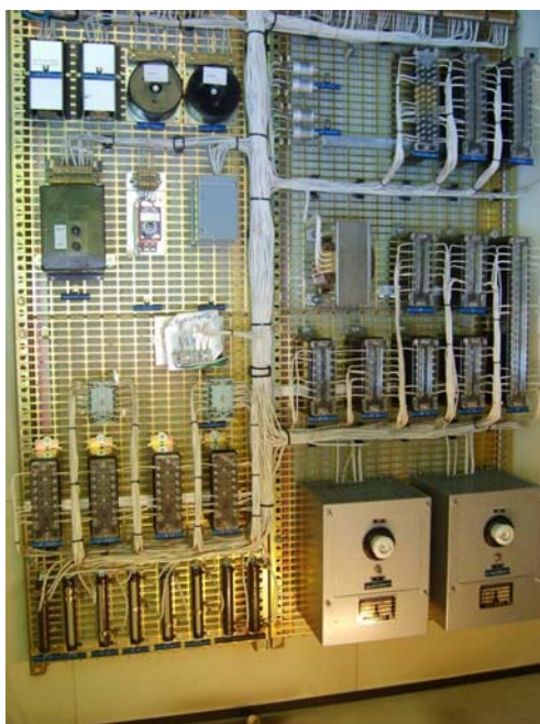
Figur 12: Dagens sikringsanlegg Kråkstad stasjon, reléanlegg bygd i 1958
