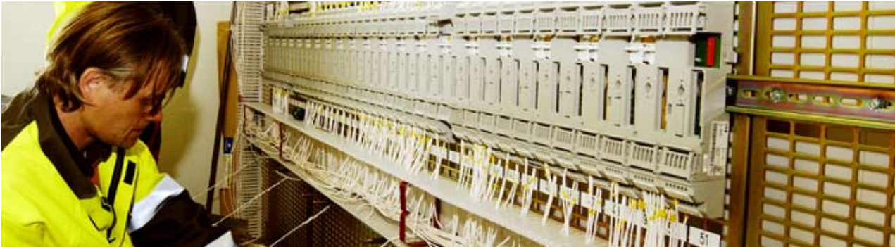
Sikringsanlegg. Foto: Jernbaneverket
