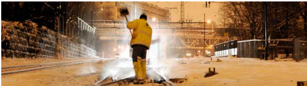
Sporvekselvarme Foto: Øystein Grue/Jernbaneverket
