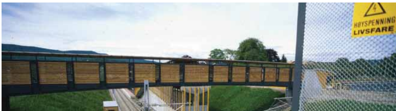
Gangbru og fareskilt ved Sande stasjon Foto: Magne Hamar/ Jernbaneverket
