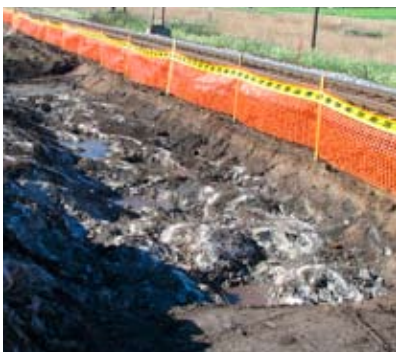
Utgraving av sterkt forurensede masser mellom bygninger og jernbane på fabrikkområdet Råde. Foto: Kjell Gulvik
