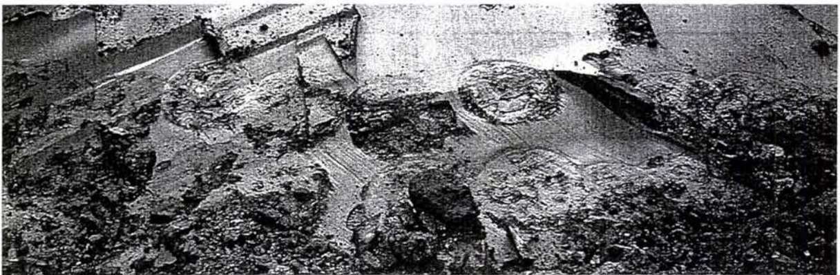
Figur 4 Bildet viser utgravet overflate for en ks-ribbe i K74 med diskontinuitet.
