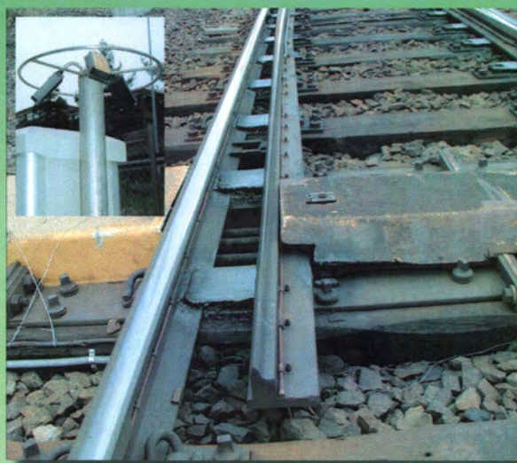
Sensoren (øvert til venstre) registrerer temperaturen og styrer varmen i sporvekselen.
